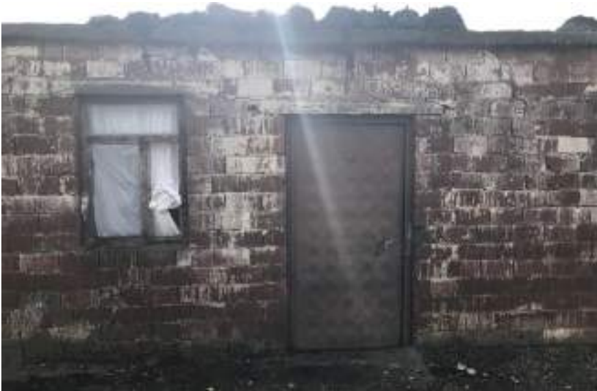
Çakırtutmaz köyünde arama sırasında zarar görmüş bir evin bir dış görünümü
